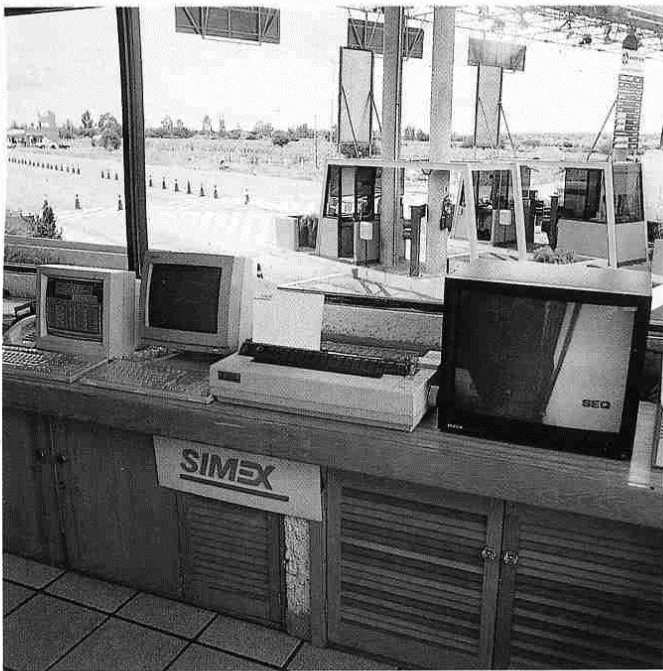
Control de peaje y auditoría por video para autopistas.
